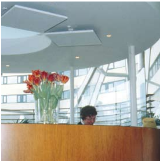
Локально добавить тепла в рабочую зону удобно с помощью потолочных кассет.
